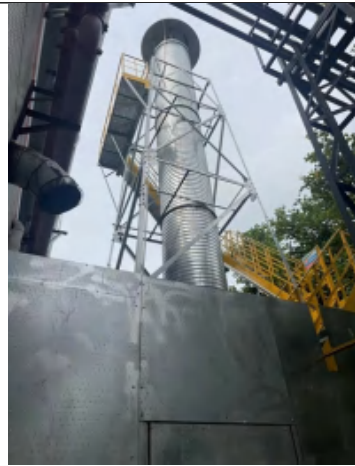
图 4.2-6 新增气-45 胶冷废气排放口远照
