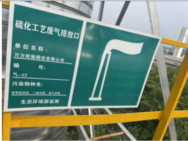
图 4.2-6 新增气-45 胶冷废气排放口近照
