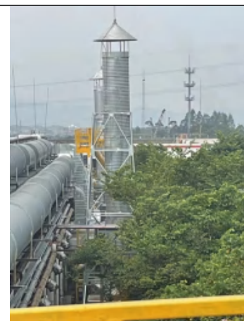
图 4.2-7 新增气-46 胶冷废气排放口远照
