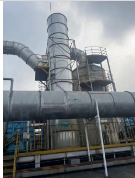
图 4.2-3 新增气-42 胶冷废气排放口远照
