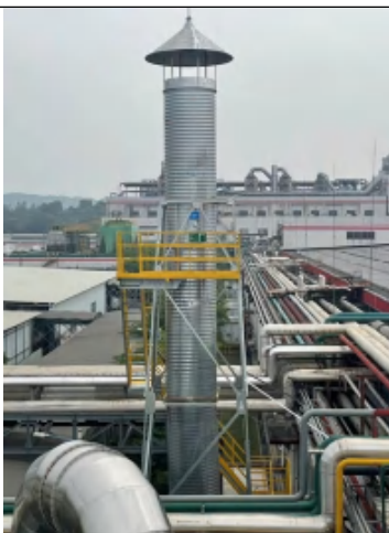
图 4.2-9 新增气-48 胶冷废气排放口远照
