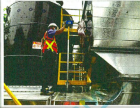
硫化车间废气 DA047 处理前监测口
