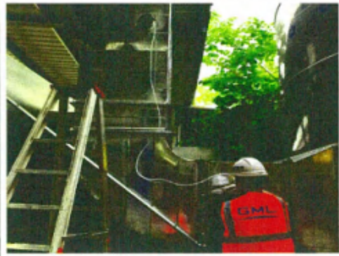
硫化车间废气 DA048 处理前监测口
