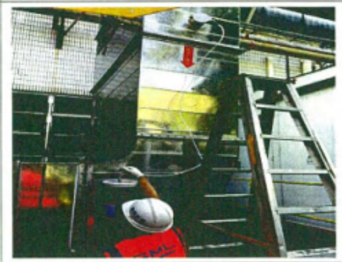
硫化车间废气 DA046 处理前监测口
