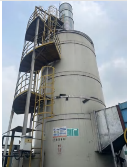
图 4.2-4 新增气-43 胶冷废气排放口远照
