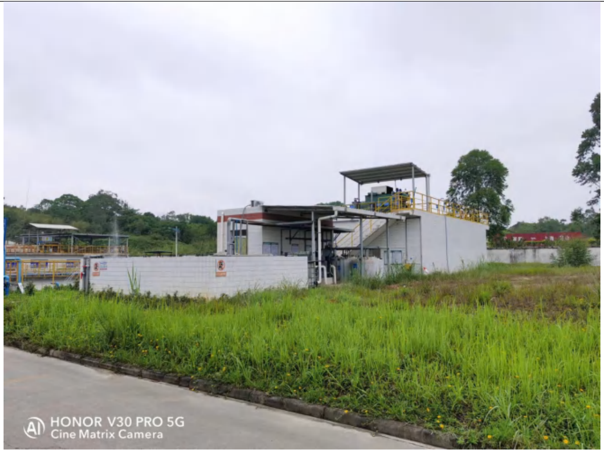
图 4.2-10 新增污水处理设施（2#）
