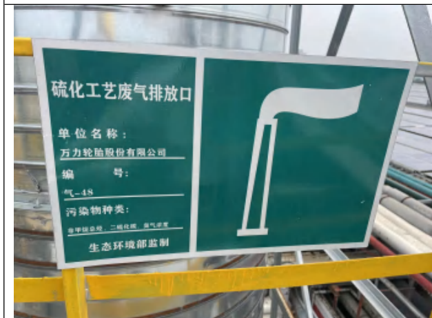
图 4.2-9 新增气-48 胶冷废气排放口近照
