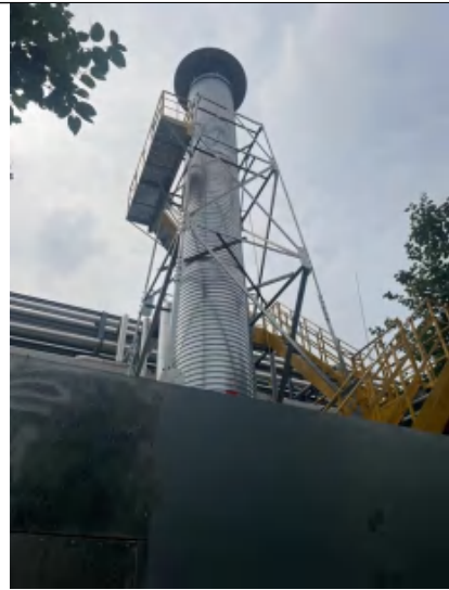
图 4.2-5 新增气-44 胶冷废气排放口远照
